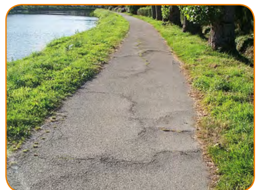
Remontées racinaires sur le revêtement en enrobé de Canal de Nantes à Brest
